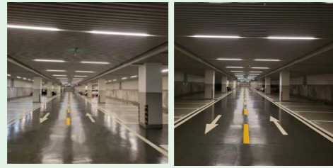
调整前停车场照明 调整前后车场照明
